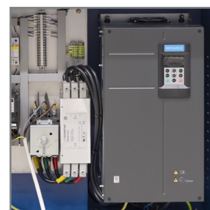
Regulace otáček nejmodernějším vektorovým frekvenčním měničem pro motor i ventilátor.
